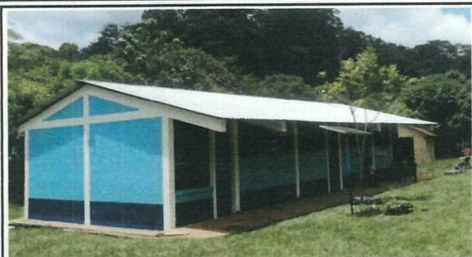
Foto 1: Existen filtraciones de agua en la cubierta de lámina, por lo tanto se requiere un cambio.
