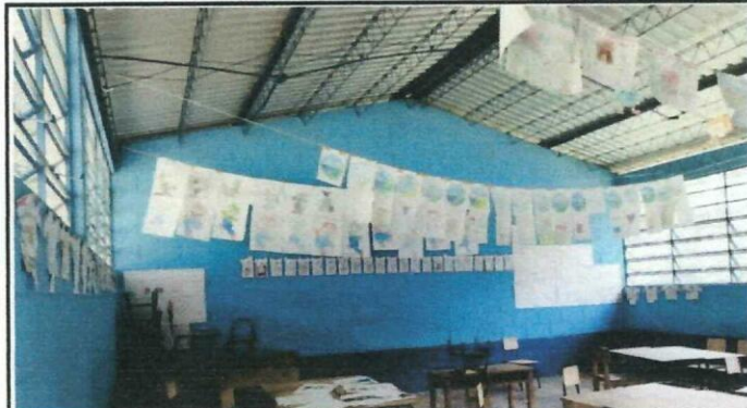
Foto 2: Las vigas eran de madera que fue pintadas de azul marino para protegerlas pero el tiempo ya necesitaban cambio.
