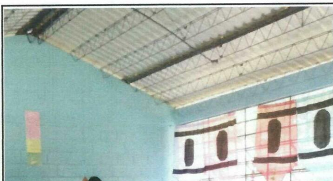
Foto 3: La estructura de techo se encuentra en mal estado, se necesita una nueva estructura.
